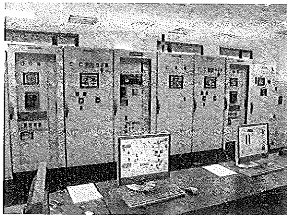
Fig. 2. CHE Plopi – camera de comandă
